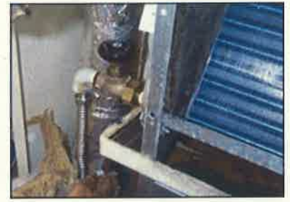
ドレンパンの排水状況
