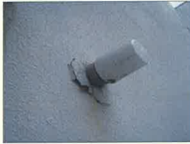
照明器具の取付け部の劣化
