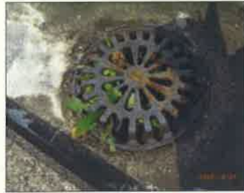
雑草の繁茂による排水能力の低下
