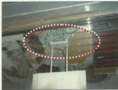
取付け部の劣化
