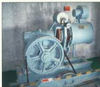
巻上機（エレベーター）
