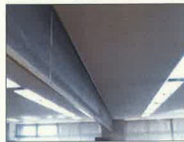
防煙壁（可動式）作動後
