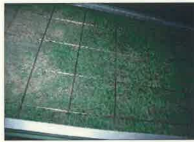
フィルターの目詰まり
