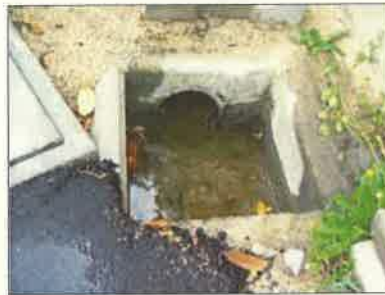
土砂が堆積し、排水不良（排水桝）
