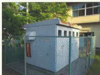
屋外設置型受変電
