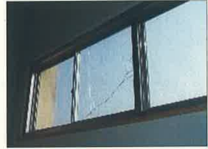
ガラスのひびわれ
