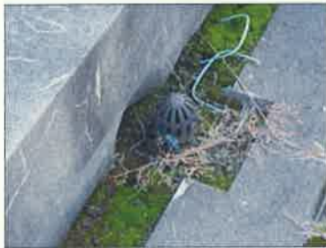
土砂等の堆積による排水能力の低下
