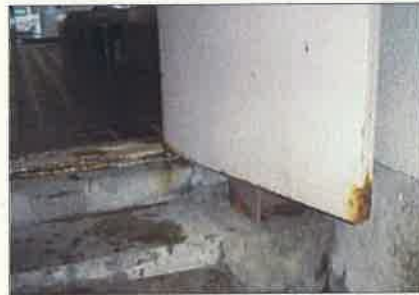
窓枠や扉の錆、腐食
