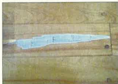
めくれ (フローリング)
