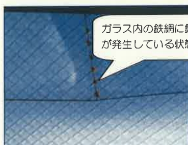
ガラスのひびわれ
