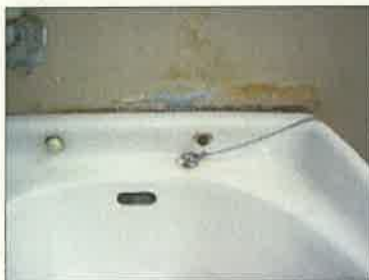
洗面台の取付不良 (AYボルト外れ)
