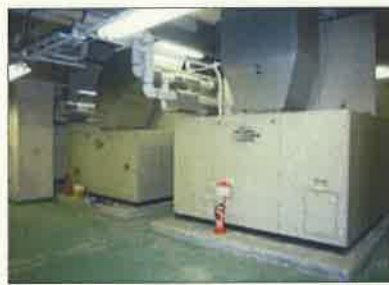
エアハンドリングユニット（AHU）
