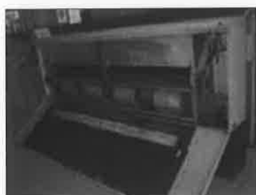
ファンコイルユニット床置型（内部開放）
