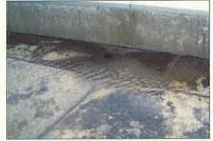
排水口の閉塞による水たまり
