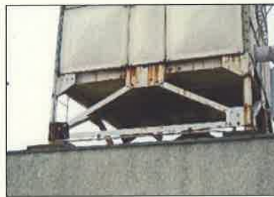
高架水槽の架台腐食
