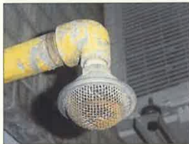
泡消火設備の腐食
