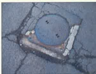
マンホール蓋のがたつき、段差
