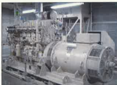
非常用発電機（オープン型）
