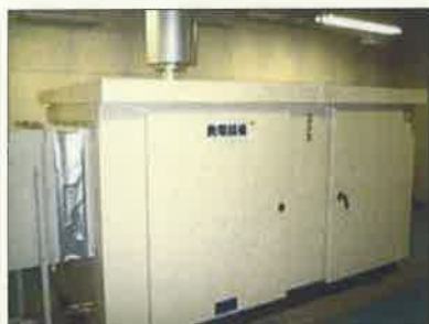
非常用発電機（キュービクル型）
