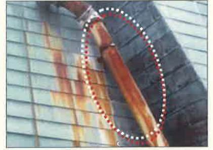
雨樋の取付け部の腐食
