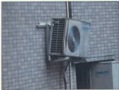
空調室外機の取り付け不良
