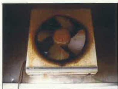
換気扇の汚れ
