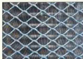
室外機のフィン
