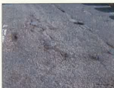
アスファルト舗装面の不陸
