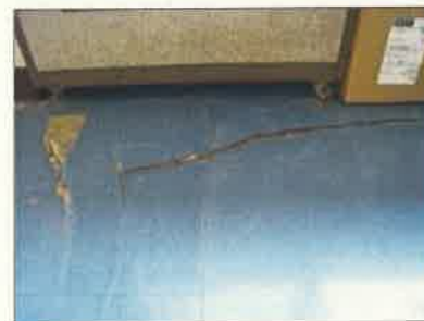
はがれ、段差 (Pタイル)
