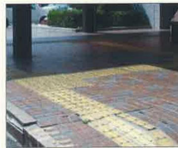
点字ブロックの破損
