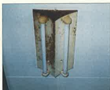
照明器具の腐食
