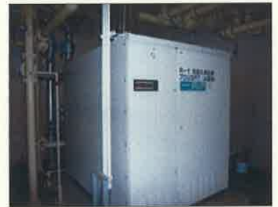
冷温水発生機
