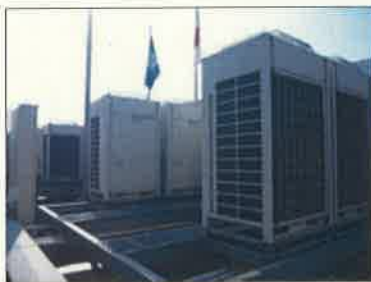
室外機の設置状況（屋上）
