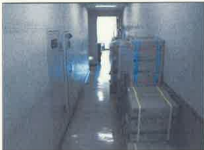
避難経路に物品が置かれており 避難時に支障となる例
