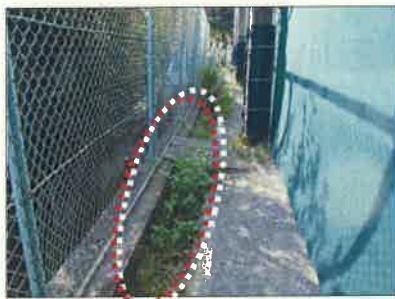
土砂が堆積し、排水不良（側溝）
