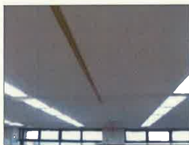
防煙壁（可動式）作動前
