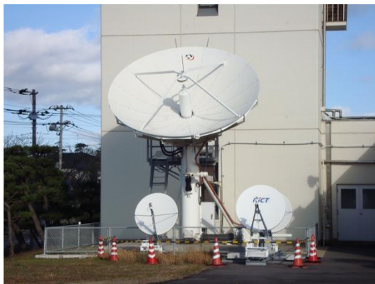
実験に使用した 5m 級アンテナを持つ大型地球局（中央）（情報通信研究機構 鹿島宇宙技術センターにて撮影）
