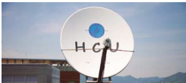
VSAT 地球局 情報工学専攻 これは衛星通信で利用する超小型地球局 (VSAT) の直径 1.8m のアンテナです。この VSAT システムは、比較的小さなアンテナを用いており、災害時における緊急通信路の確保や多地点への映像伝送等を可能としています。
